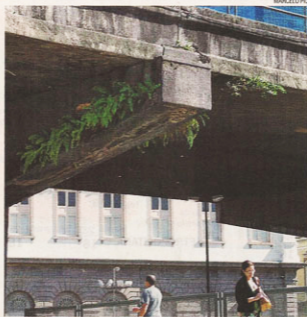
Jardim fora de lugar. Plantas crescem na Perimetral: conservação precária
