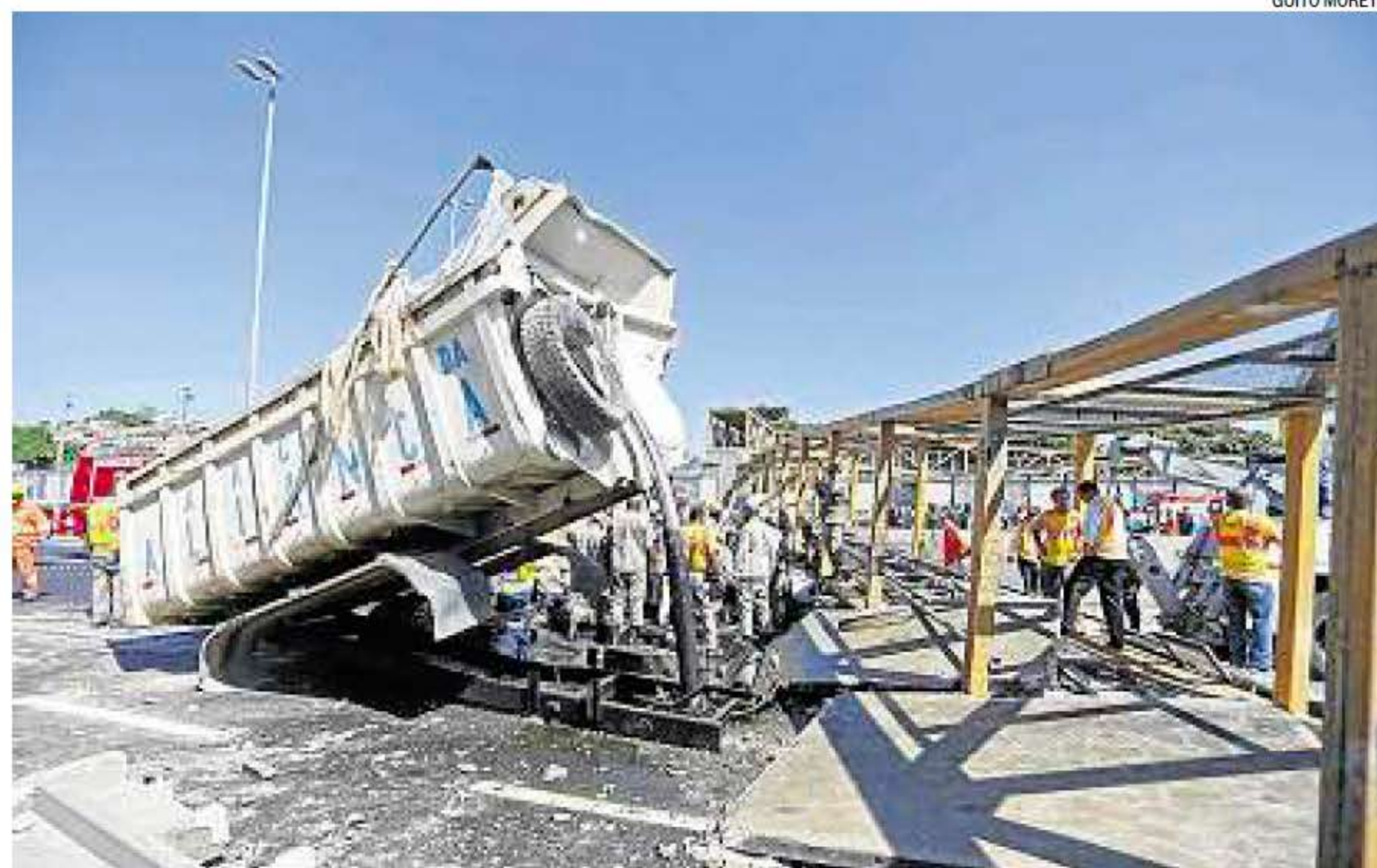
Tragédia. A caçamba do caminhão basculante que colidiu com a passarela da Linha Amarela derrubando a estrutura
